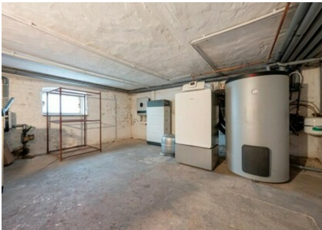
Heizungsanlage mit Warmwasser- und Stromspeicher
