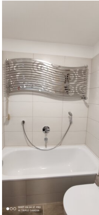
1_Bad 2 Design Heizkörper
