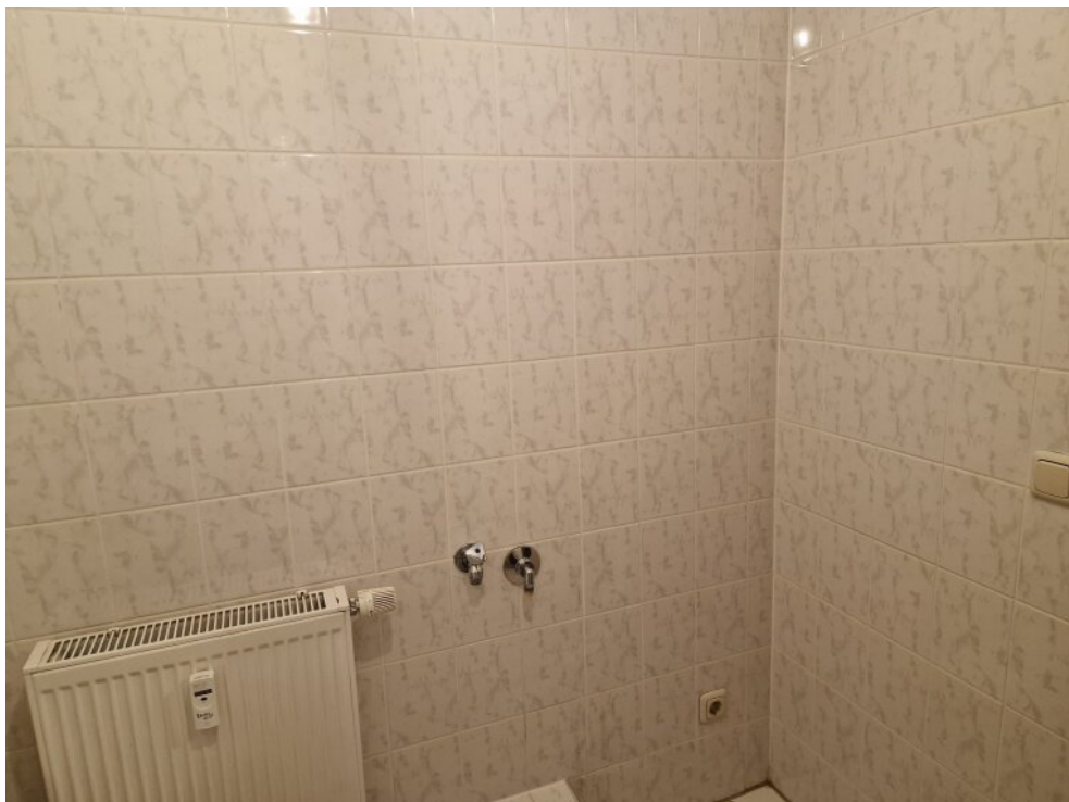
Waschmaschinenanschluss im Bad
