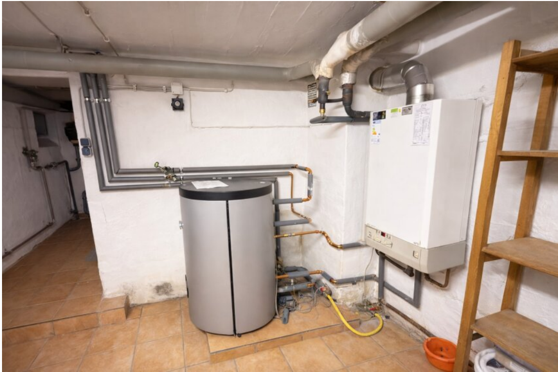
Heizungsraum mit Warmwasserboiler
