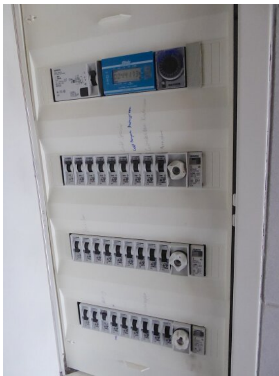
Sicherungskasten Wohnung OG
