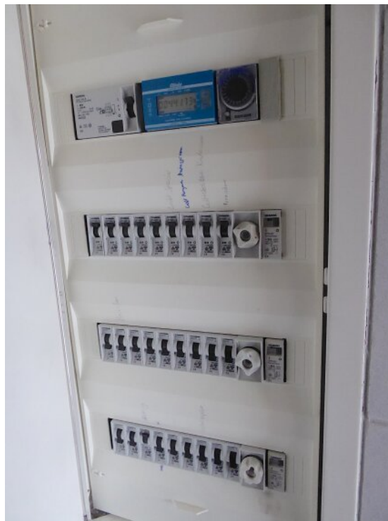
Sicherungskasten Wohnung OG
