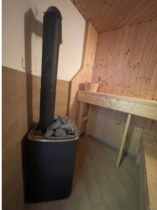
Sauna im Keller
