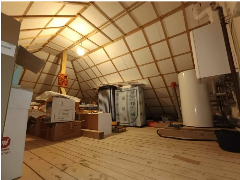
Gas-Heizung im Dachgeschoss
