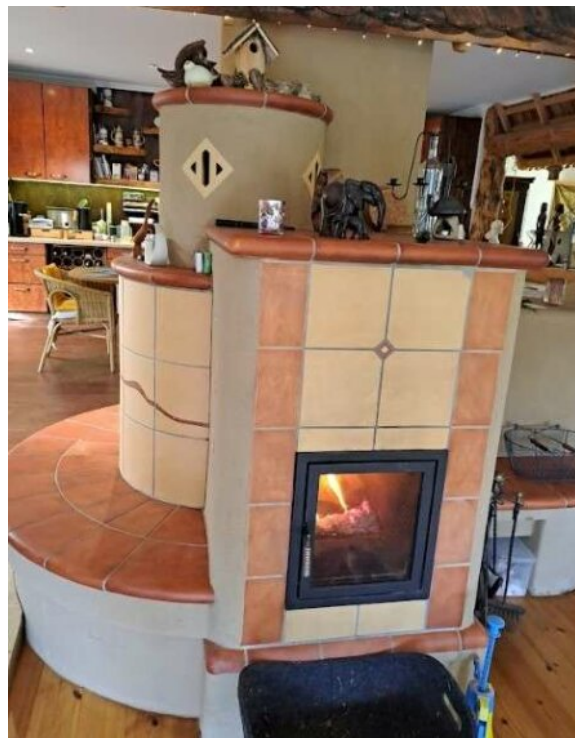
Grundofen im Wohnbereich
