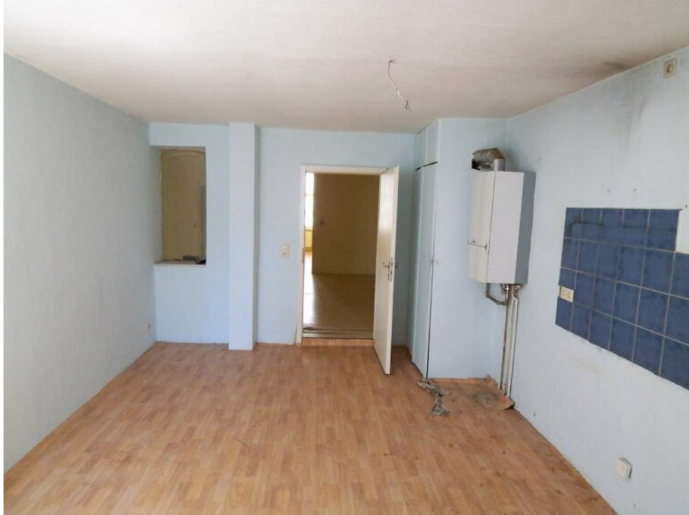
Küche im 1.OG mit Etagenheizun
