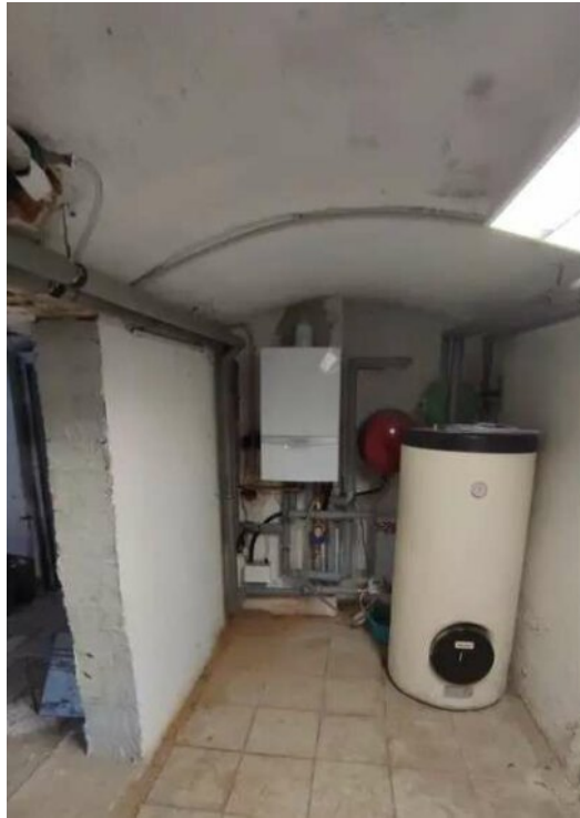
Gasheizung mit WW-Speicher im
