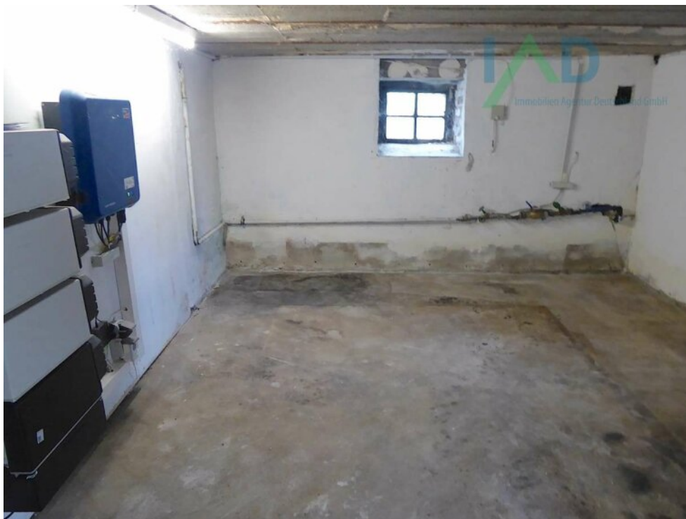
Kellerraum mit Anschluss Photo
