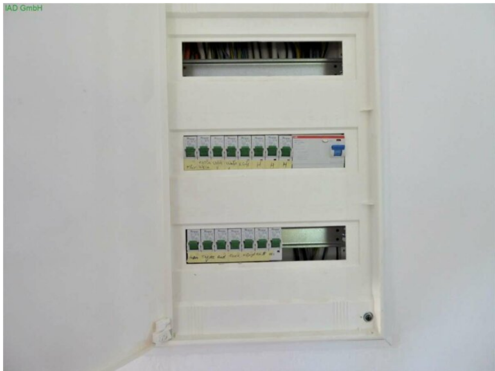
Unterverteilung Strom im Haus
