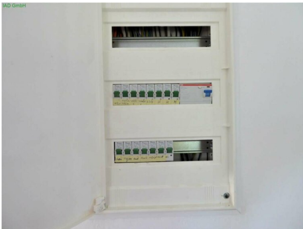
Unterverteilung Strom im Haus
