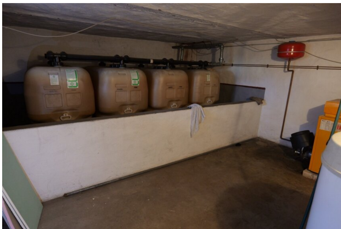
Öl-Heizung im Keller
