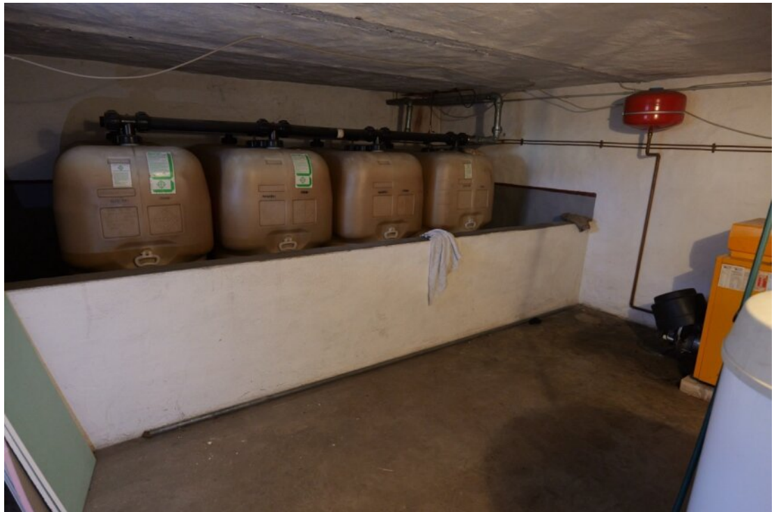
Öl-Heizung im Keller
